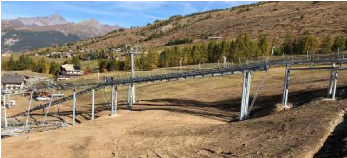
EXEMPLES DE PASSERELLE SUR PISTE : LUGE VERDON EXPRESS A ALLOS (04)
